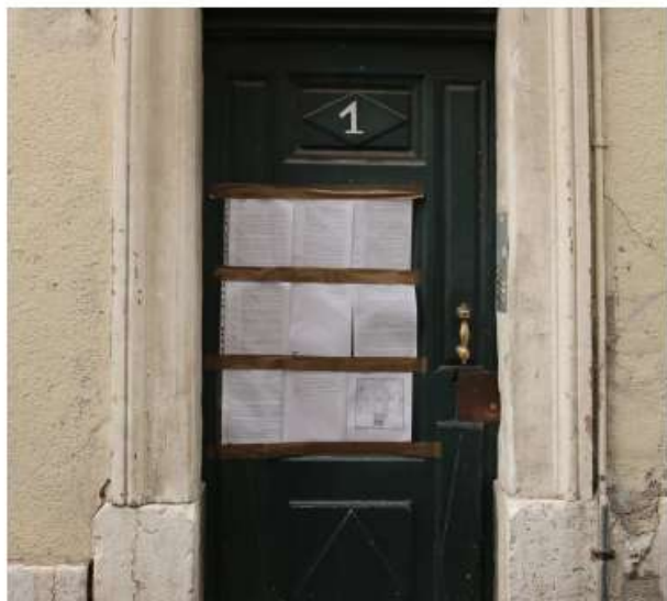
« Risque d'effondrement d'une partie de l'escalier » indique notamment l'arrêté de péril imminent du 1, rue Lafayette PHOTO DC
