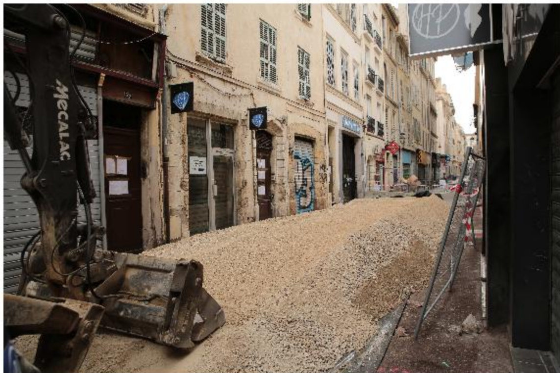
La déconstruction au frais de la Ville durant 6 à 8 semaines se fera « tuile par tuile » a dit hier l'adjoint délégué à la sécurité, Julien Ruas, à une centaine d'habitants convoqués en mairie. PHOTO DC
