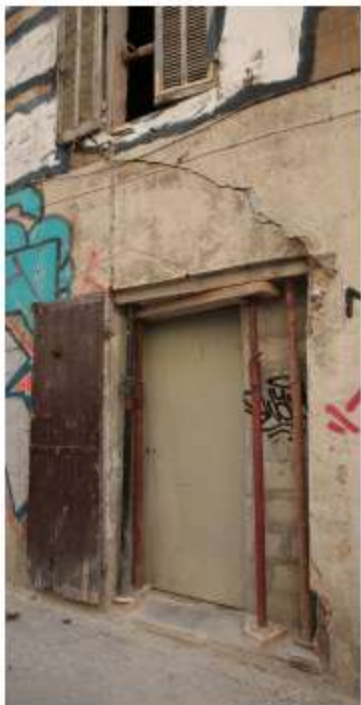
Rue Clovis-Hugues, de nombreux immeubles sont en péril. PHOTO D.C.
